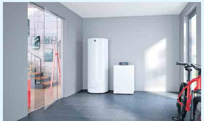
Durch Sole-Wasser-Wärmepumpen Energie gewinnen
