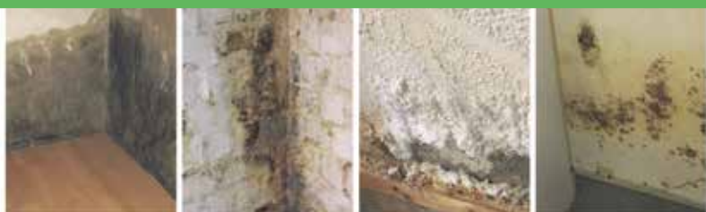
Defekte Horizontalsperre Querdurchfeuchtung Ausblühungen Schimmelbefall
