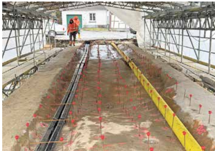
Zwischenstand bei der Sanierung der Mühlenbrücke: Die Bewehrung wurde eingebaut, danach konnte die erste von insgesamt zwei neuen Betonschichten aufgebracht werden. Foto: Horst Klapp GmbH
