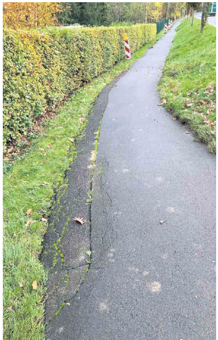
In einem schlechten Zustand befindet sich der Rad-/Gehweg am Ohlerhammer - jetzt wird er erneuert. Foto: Stadt Wiehl
