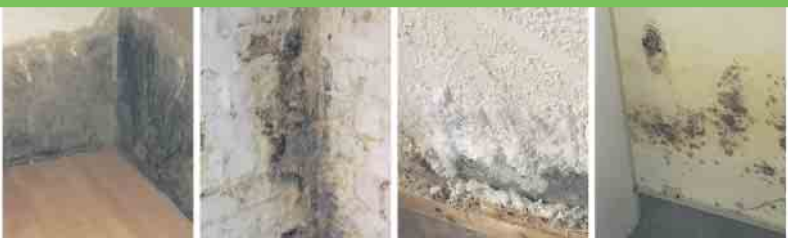
Defekte Horizontalsperre Querdurchfeuchtung Ausblühungen Schimmelbefall
