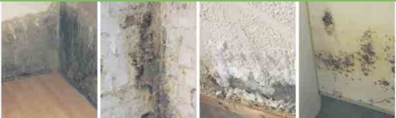
Defekte Horizontalsperre Querdurchfeuchtung Ausblühungen Schimmelbefall
