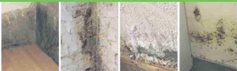
Defekte Horizontalsperre Querdurchfeuchtung Ausblühungen Schimmelbefall
