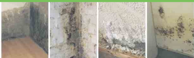
Defekte Horizontalsperre Querdurchfeuchtung Ausblühungen Schimmelbefall
