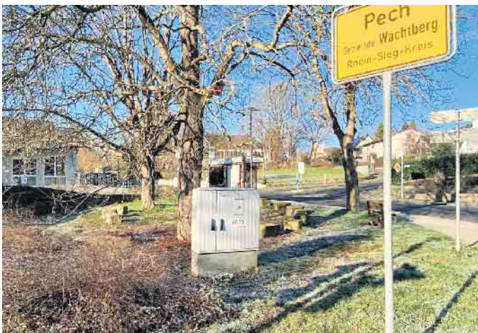
Verteilerkasten Pecher Ampelkreuzung
