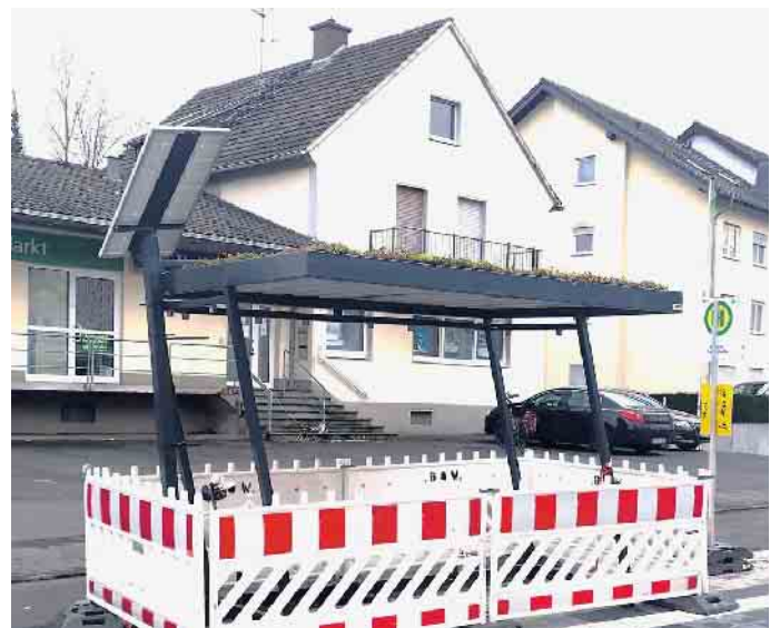
Beschädigte Haltestelle Raiffeisenbank
