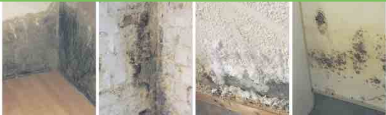
Defekte Horizontalsperre Querdurchfeuchtung Ausblühungen Schimmelbefall
