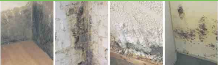
Defekte Horizontalsperre Querdurchfeuchtung Ausblühungen Schimmelbefall
