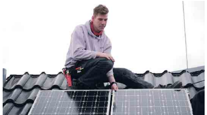
Dächer sind mehr als Ziegel. Auch die Montage von Photovoltaikanlagen gehört zum Dachdeckerhandwerk. Foto: ZVDH/akz-o
