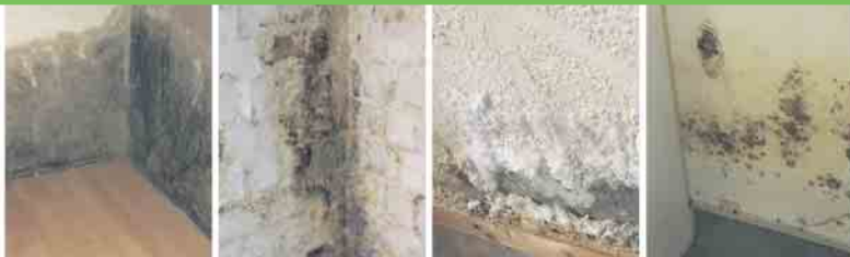
Defekte Horizontalsperre Querdurchfeuchtung Ausblühungen Schimmelbefall
