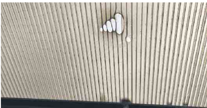
Ärgerlich und unverständlich: Unbekannte Täter haben ein Loch in das Dach des neuen Pavillons gebrannt.
