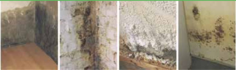
Defekte Horizontalsperre Querdurchfeuchtung Ausblühungen Schimmelbefall
