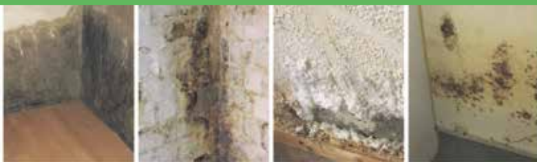
Defekte Horizontalsperre Querdurchfeuchtung Ausblühungen Schimmelbefall
