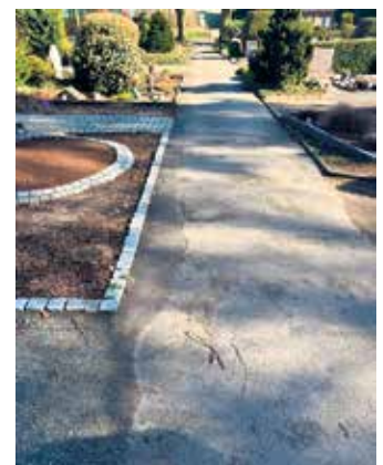
Abbruchkanten und Risse in den Wegen. Bildrechte: Stadt Straelen
