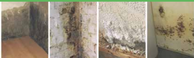
Defekte Horizontalsperre Querdurchfeuchtung Ausblühungen Schimmelbefall
