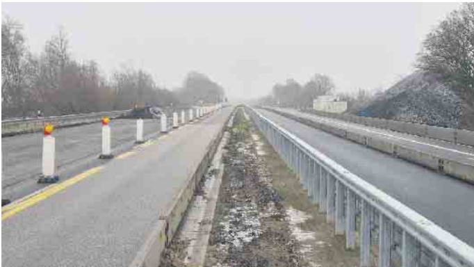
Blick auf die gesperrte Autobahn A59
