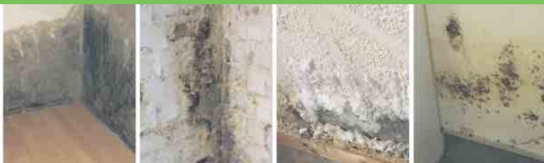
Defekte Horizontalsperre Querdurchfeuchtung Ausblühungen Schimmelbefall
