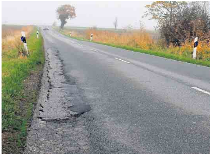
Kompletter Sanierungsfall: Streckenabschnitt der L360 nahe Naafer Brücke
