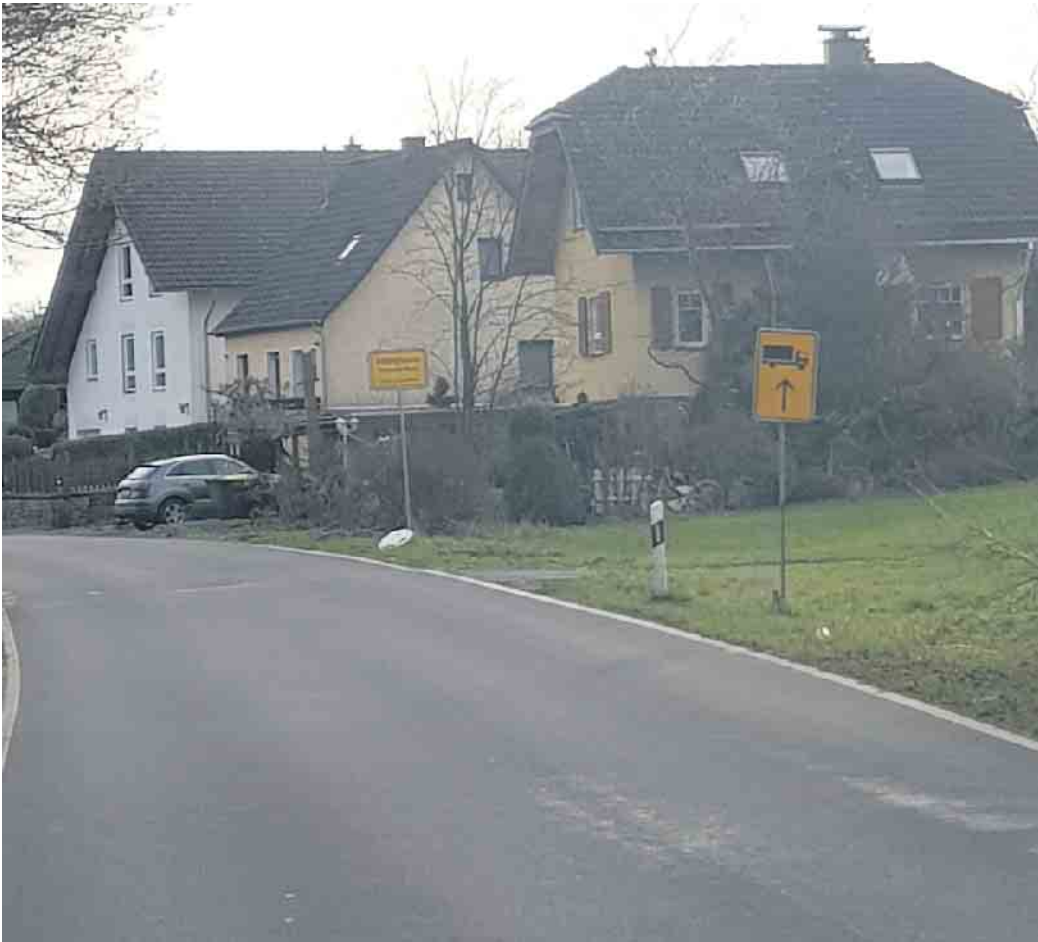
Fehlende Fahrbahnmarkierung gefährdet die Sicherheit aller Verkehrsteilnehmer auf der K46
