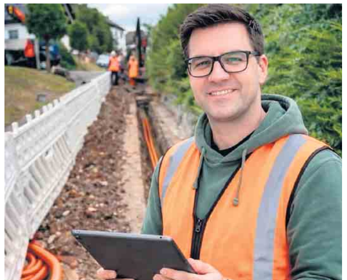
William Rahn vom Tiefbauamt der Stadt Lohmar bei der Kontrolle einer Glasfaserbaustelle: Mit hoher Präsenz vor Ort begleitet die Stadtverwaltung den Ausbau der digitalen Infrastruktur im gesamten Stadtgebiet.
