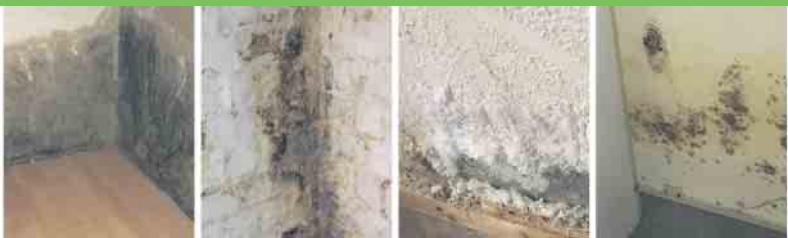
Defekte Horizontalsperre Querdurchfeuchtung Ausblühungen Schimmelbefall
