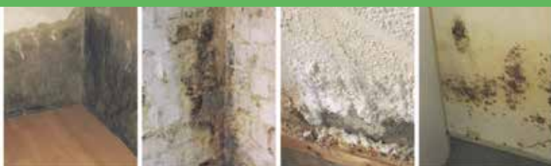
Defekte Horizontalsperre Querdurchfeuchtung Ausblühungen Schimmelbefall
