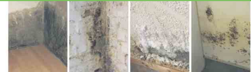
Defekte Horizontalsperre Querdurchfeuchtung Ausblühungen Schimmelbefall
