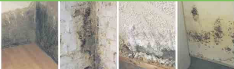
Defekte Horizontalsperre Querdurchfeuchtung Ausblühungen Schimmelbefall
