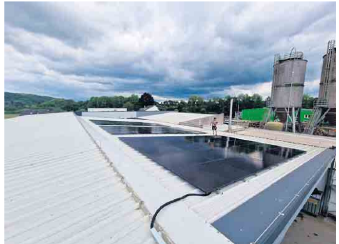
Hennefer Baubetriebshof erzeugt seinen Strom nun selbst.
