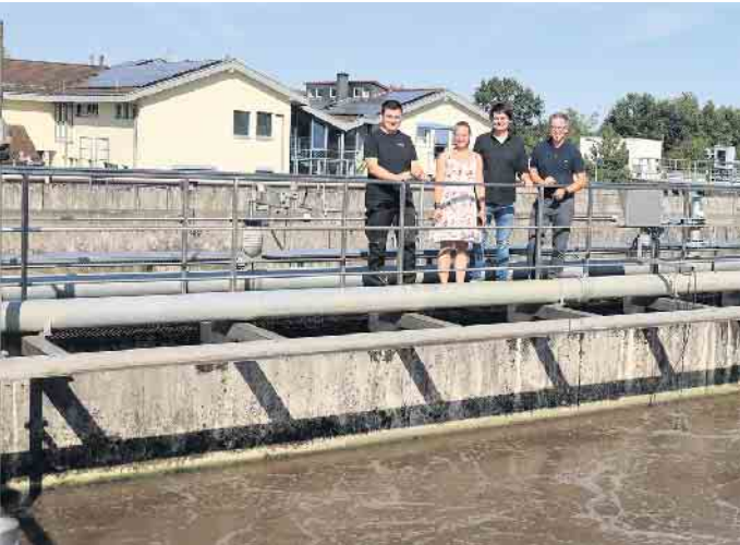
Über die Erneuerung der technischen Ausrüstung der Belebungsbecken freuen sich (v.r.) Betriebsleiter Dr. Volker Erbe, Bürgermeister Mario Dahm, Dana Schmetkamp, Fachbereichsleitung Abwasserbetrieb, und Nils Weller, Fachkraft Abwassertechnik.
