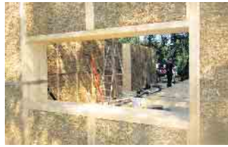
Foto: Biber Naturbaustoffhandel / ÖkoPlus AG / BHW Bausparkasse
