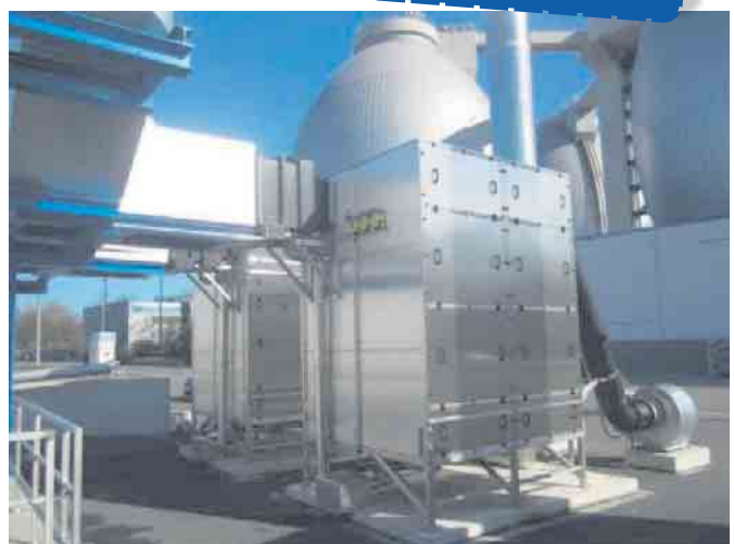
Neutralox Photoionisation auf der Kläranlage Emscher Mündung
