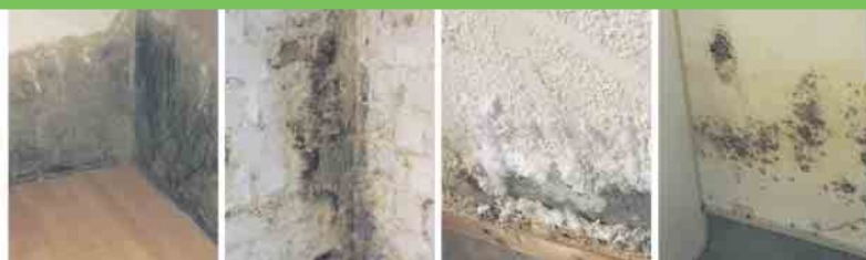
Defekte Horizontalsperre Querdurchfeuchtung Ausblühungen Schimmelbefall
