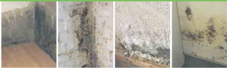
Defekte Horizontalsperre Querdurchfeuchtung Ausblühungen Schimmelbefall
