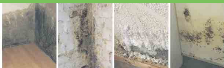
Defekte Horizontalsperre Querdurchfeuchtung Ausblühungen Schimmelbefall
