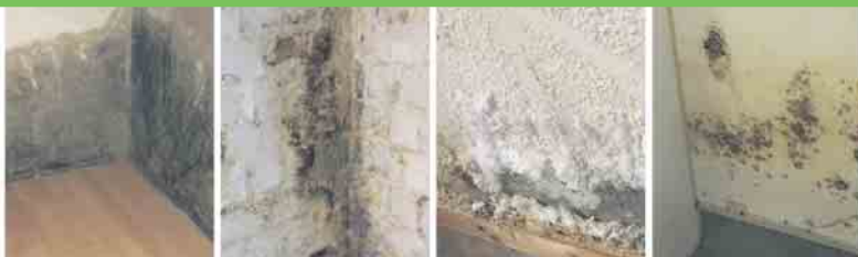
Defekte Horizontalsperre Querdurchfeuchtung Ausblühungen Schimmelbefall
