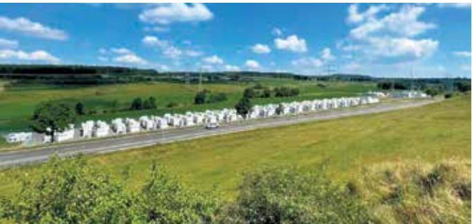
Der Batteriespeicher an der B 51, rechts das Dahlemer Umspannwerk. © Gemeinde Dahlem
