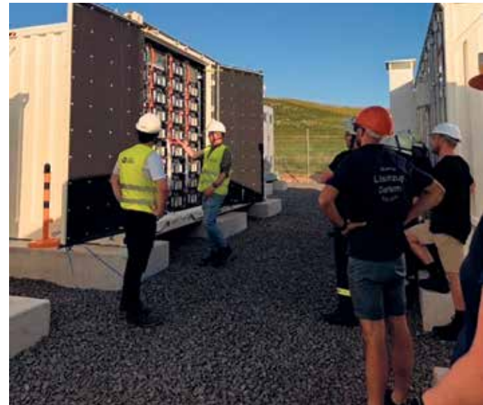
Die Feuerwehr aus der Gemeinde Dahlem wurde vom Betreiber über die Brandschutztechnik der Anlage informiert. © Gemeinde Dahlem
