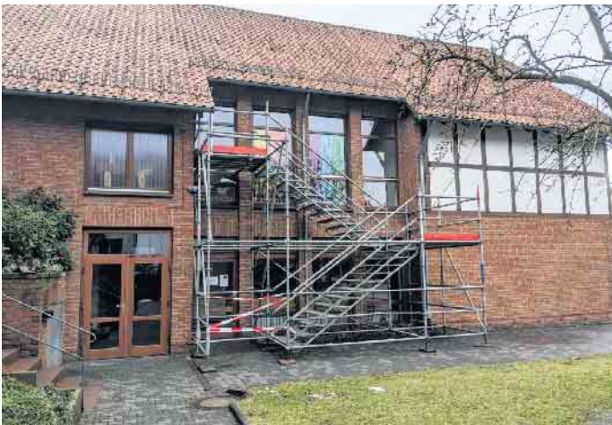
Ein Treppengerüst an der Eingangsseite des Pfarrheims fungiert als temporärer zweiter Flucht- und Rettungsweg für den Notfall.
