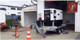
Das im Feuerwehrgerätehaus in Enzen stationierte Notstromaggregat ist eines von mehreren Geräten, das die Stadt Zülpich angeschafft hat, um die Handlungsfähigkeit der Feuerwehr im Falle eines Blackouts zu gewährleisten. in Silber der Landesjugendfeuerwehr NRW ausgezeichnet.
