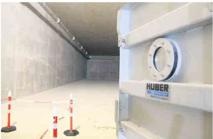
Jede der zwei Wasserkammern fasst einen gesamten Tagesbedarf.
