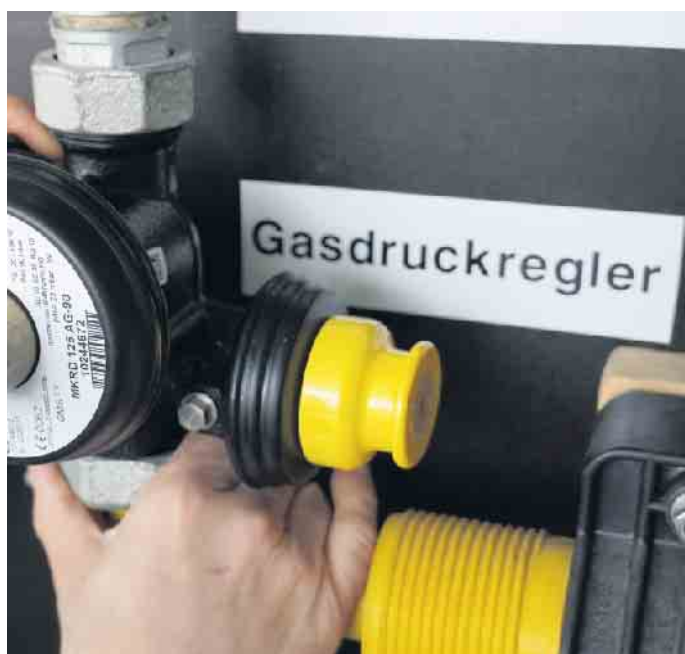
Die Westnetz GmbH tauscht derzeit bei den mit Erdgas versorgten Haushalten in Brakel den Gasdruckregler gegen ein Modell mit installierter Gasmangelsicherung aus. Foto: Westnetz
