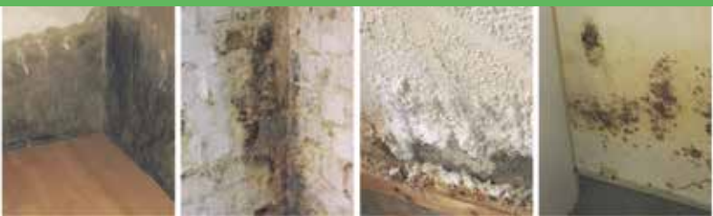
Defekte Horizontalsperre Querdurchfeuchtung Ausblühungen Schimmelbefall
