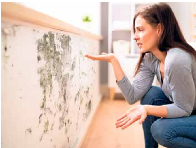
Feuchte, Schimmel und Lüften - Quelle: Andrey Popov/ AdobeStock
