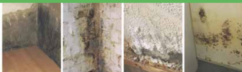
Defekte Horizontalsperre Querdurchfeuchtung Ausblühungen Schimmelbefall
