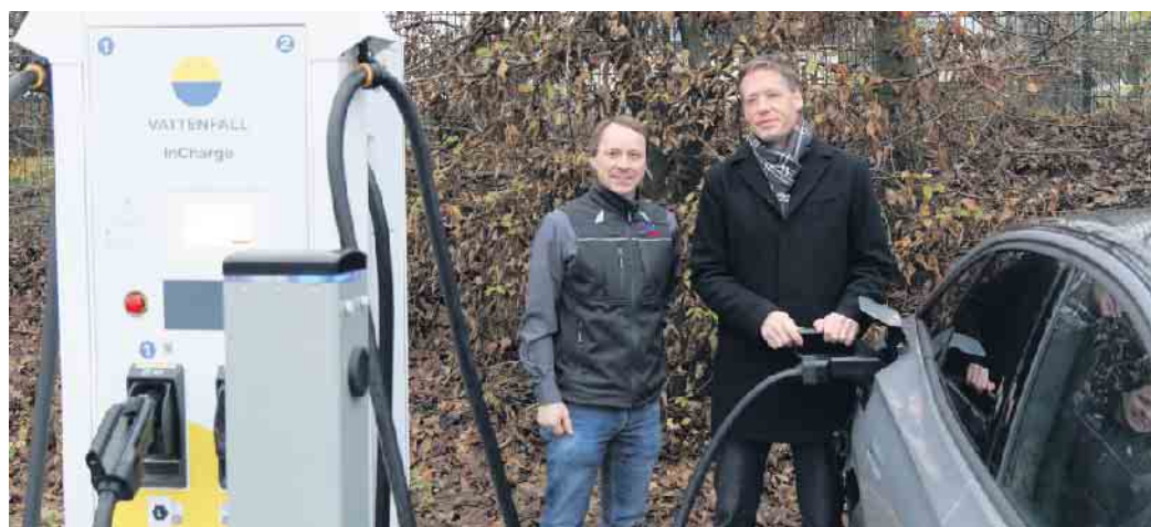
Herr Urban und Bürgermeister Matthias Möllers an der neuen Schnellladesäule
