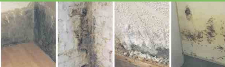
Defekte Horizontalsperre Querdurchfeuchtung Ausblühungen Schimmelbefall
